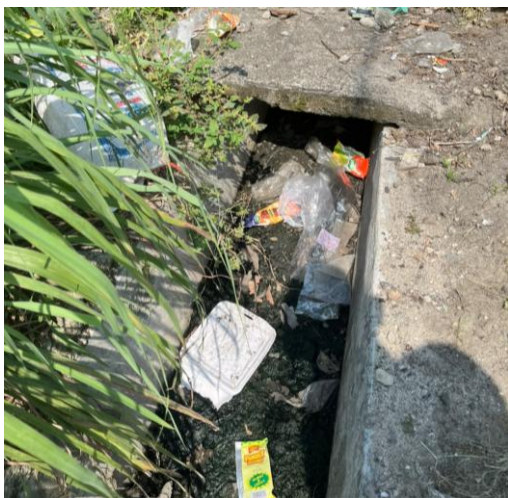
Gambar 1. Kondisi Drainase dengan Tumpukan Sampah
