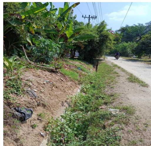
Gambar 2. Kondisi Drainase yang Tertutup Rumput
